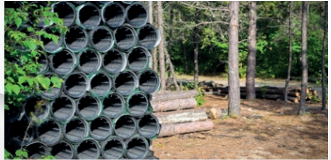
144 conduites au total, divisée en trois cellules
