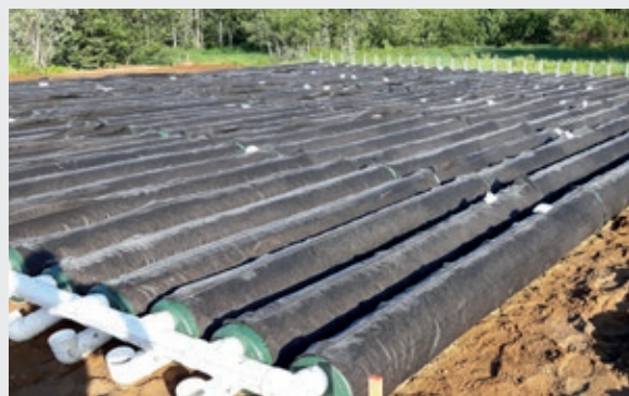
Les conduites Advanced Enviro))Septic connectées
